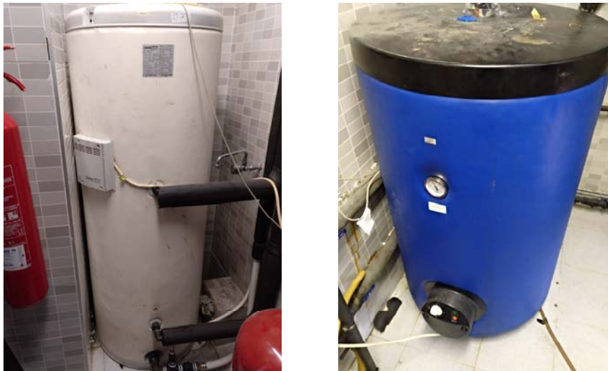
Imagen 14. Acumulador solar (blanco) y acumulador con resistencia eléctrica de apoyo (azul)
