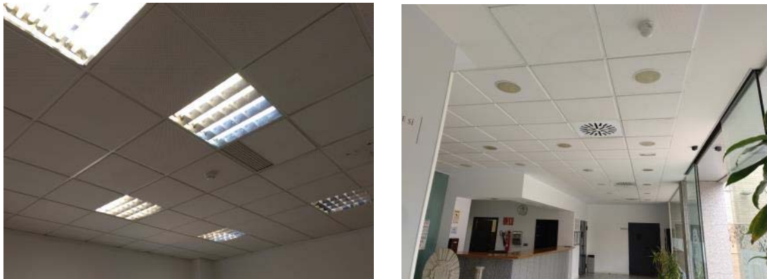
Imagen 7. Luminarias instaladas en el centro
