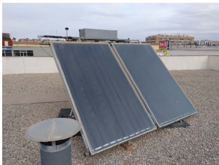
Imagen 13. Captadores solares planos de instalación solar térmica
