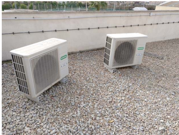
Imagen 12. Unidades exteriores de la sala Rack y sala de tiro
