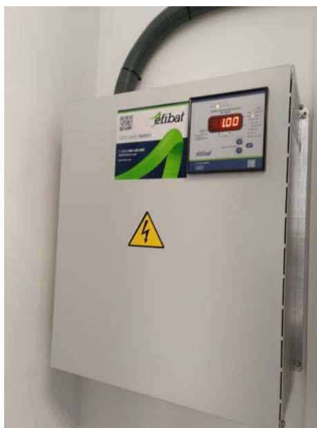
Imagen 18. Batería de condensadores en funcionamiento
